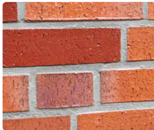
Bild 1: Unbehandelte Fassade. Das Wasser wird vom Baustoff aufgenommen
